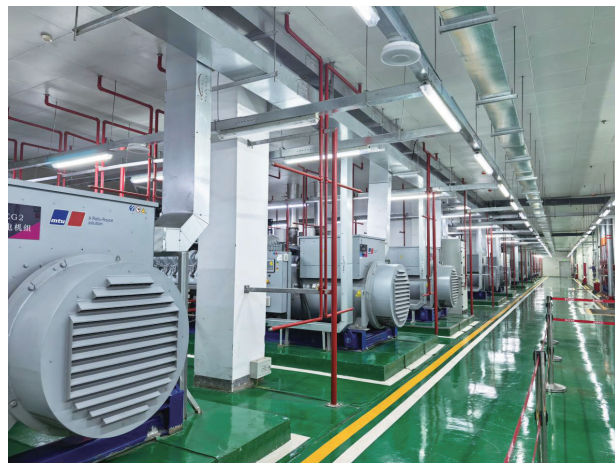
合肥城市云数据中心发电机组。
