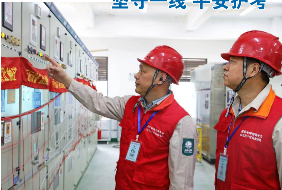
6月7日,国网长丰县供电公司高考保电人员在辖区各考点开展保电值守工作,全力护航高考用电稳定无忧。 耿皓 摄
