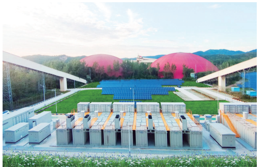
获港海螺全钒液流电池储能电站。
